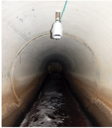
Abbildung 10 Installation des SQ-R Sensor in einem Abwasserkanal
