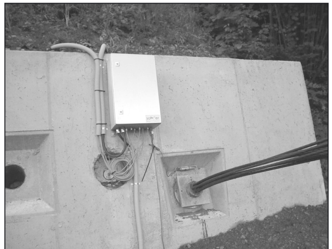
Messstation mit Ankerkraftmessdose
