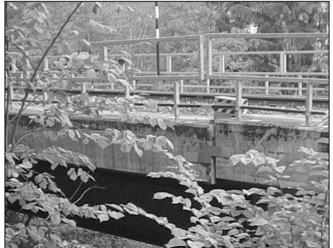
Verschiebung der Brückenfuge
