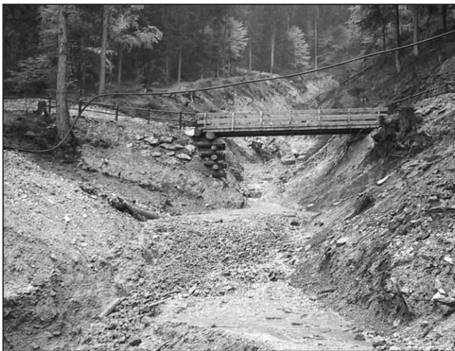
Murgang (Aufnahme Überwachungskamera)
