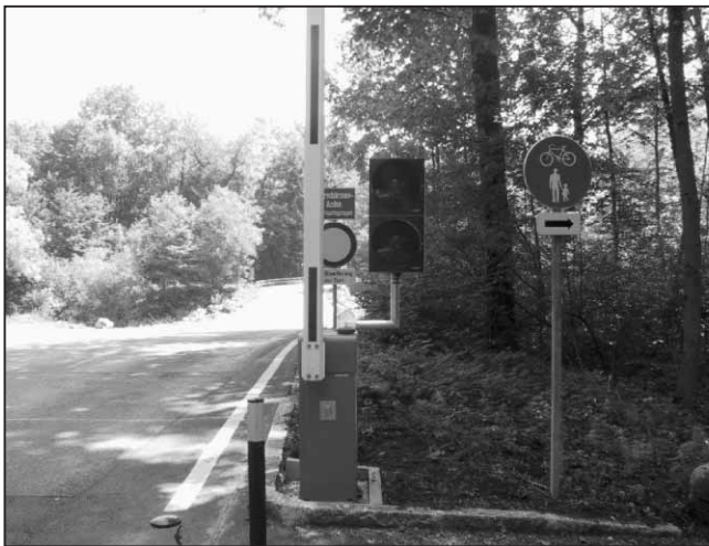
Schrankenanlage der Firma Siemens
